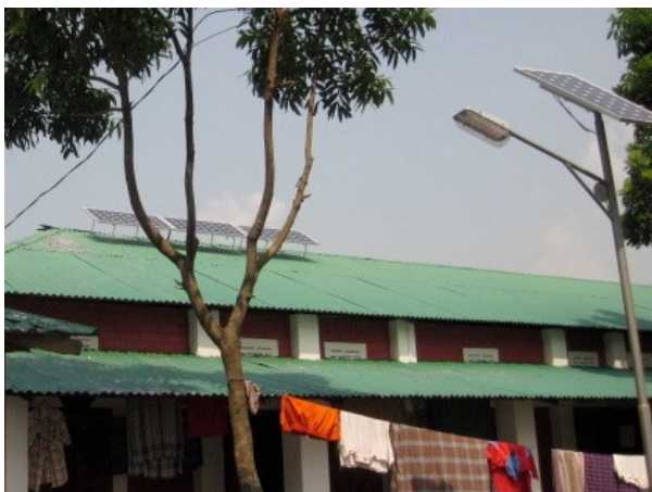
Die Solarpanels auf dem Dach, im Vordergrund die Platzbeleuchtung
