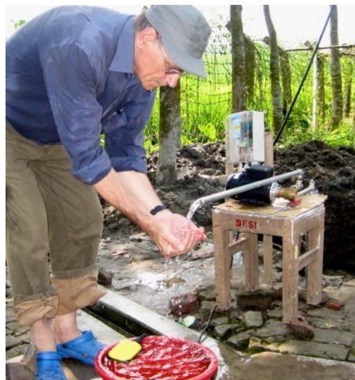
Eine mit Sonnenenergie betriebene Wasserpumpe. Das Wasser ist problemlos trinkbar
