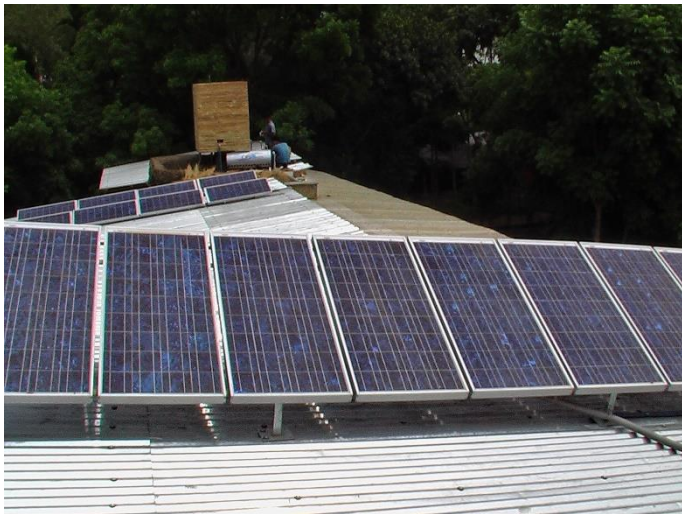
49 Im Vordergrund sind die Panels für Licht und Fan zu sehen und im Hintergrund jene für die solare Wasserpumpe.
