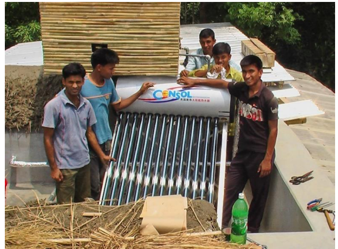
50 Für das Duschwasser sorgt ein kleiner Heisswasserkollektor mit aufgebautem Boiler, den sie selbst zusammengebaut haben.
