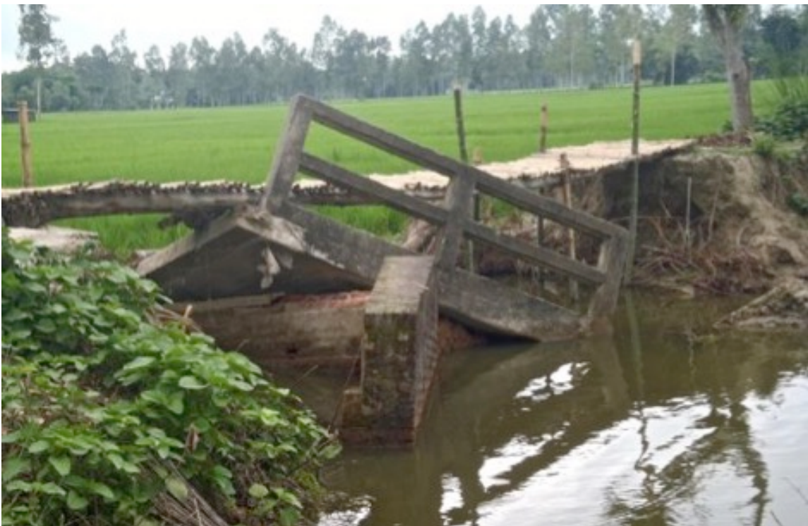
In der Nähe unserer Elektrikerschule wurde diese Brücke unterspült. (September 2017)
