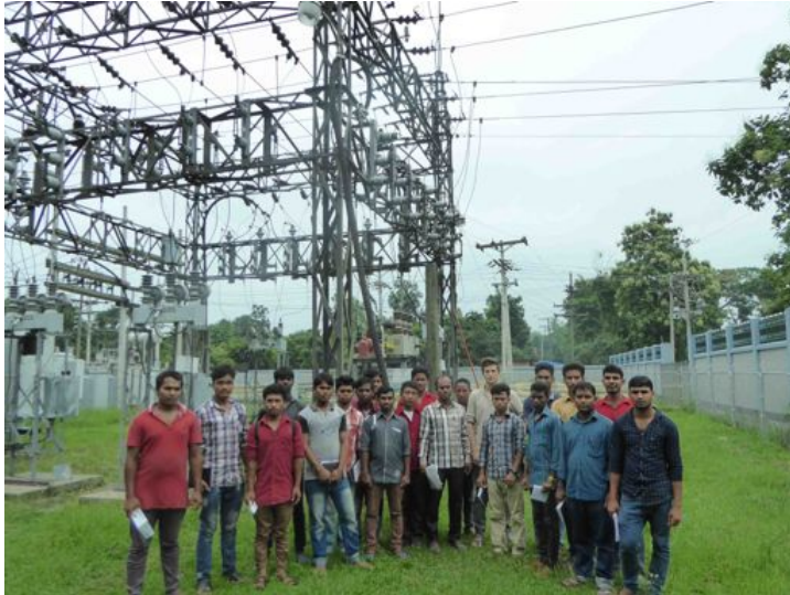
Hochspannungsverteilanlage in Dinajpur.
