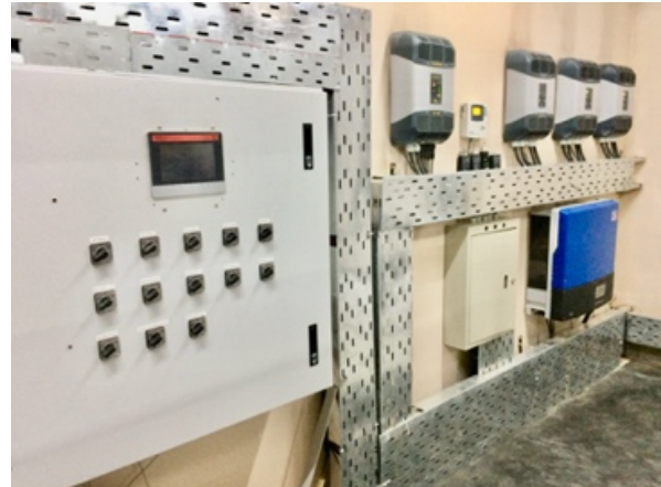
Ladegeräte für die Batterien und die Wechselrichter
